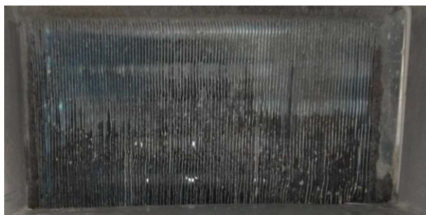
Zabrudzony wymienник ciepła
