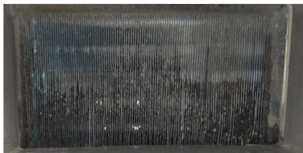
Zabrudzony wymienник ciepła
